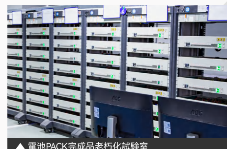
▲ 電池PACK完成品老朽化試験室
